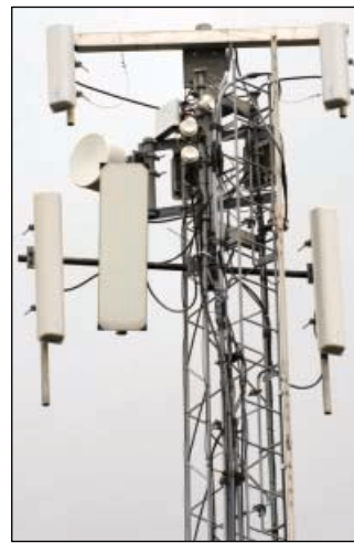
Test-rig Wimax mast
